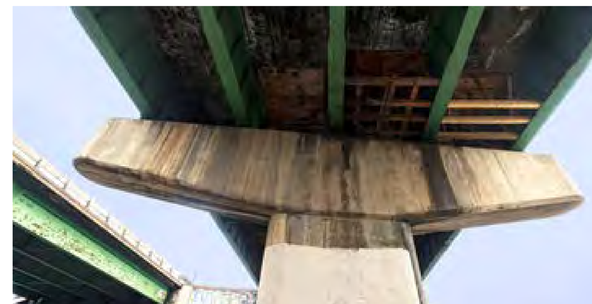
Deteriorating bridge conditions on I-270 over Brighton Boulevard Deterioro de las condiciones del puente en la I-270 sobre Brighton Boulevard
